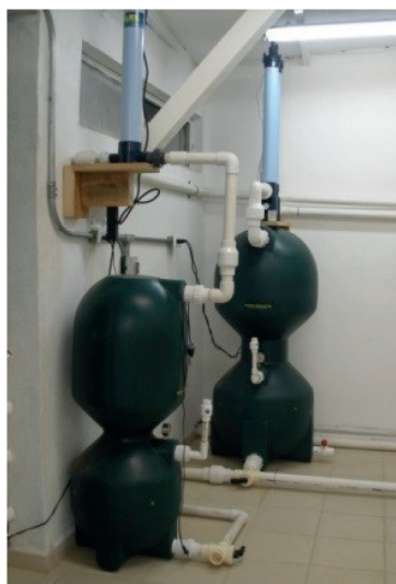
FIG. 26. Sistema de filtración integrado a tanques y canaletas en recirculación.
