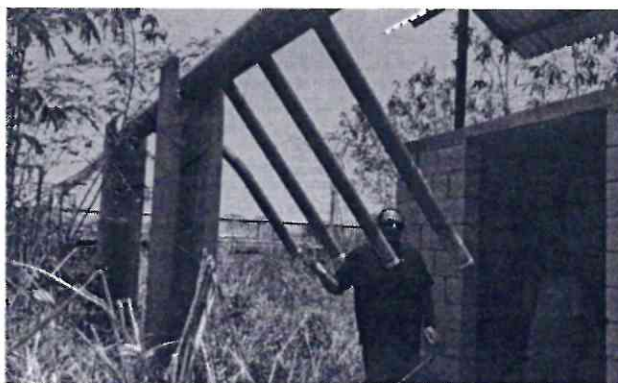
Figura 7. Caseta para instalación de blowers, zona de raceways al fondo.
